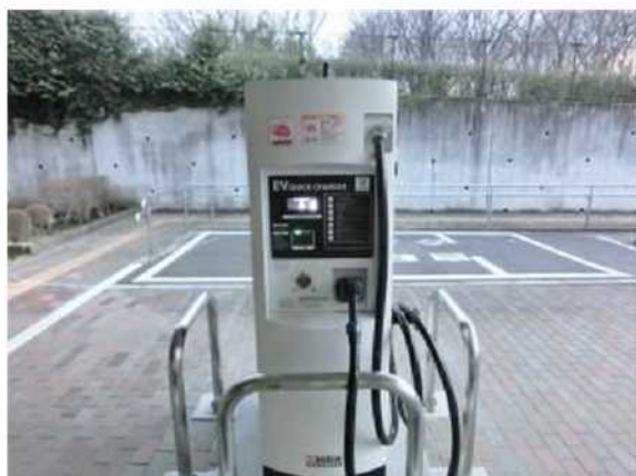
急速充電器 (所沢市東部クリーンセンター)
